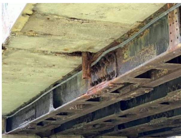
7 pav. Nesandari hidroizoliacija, po šalitilčiais latakai, prie vandens nuleidimo šulinėlių – kiaura.
