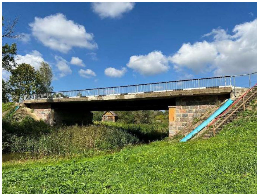
10 pav. Nusidėvėjęs sijų apsauginis sluoksnis, korozijos pažeidimai, didesnės pažaidos prie vandens nuleidimo šulinėlių. Matomas tilto sijų įlinkis.
