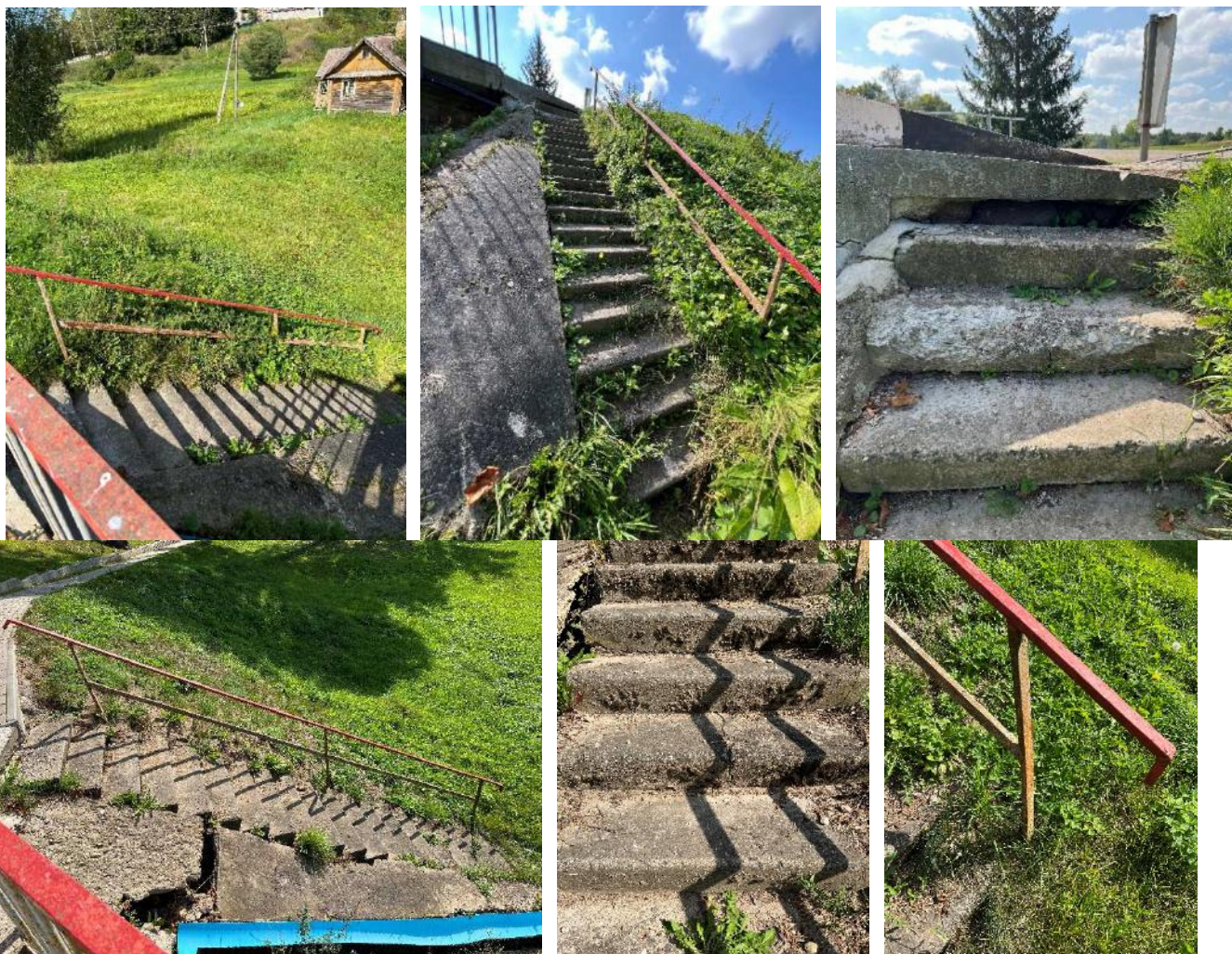
13 pav. Nutrupėjęs betonas nuo šlaitinių laiptų pakopų, apaugę žolėmis. Pažeista turėklų apsauginė danga, koroduoja.
