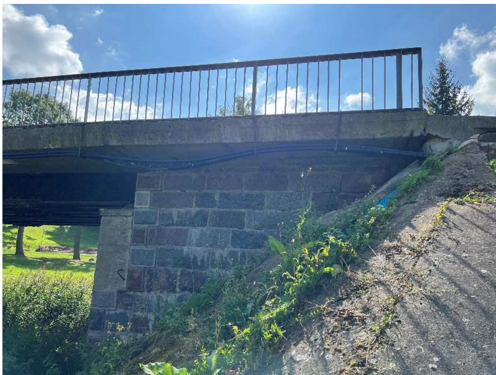
16 pav. Kūgiuose tarp sutvirtinimo plokščių apaugę žolėmis, plokštės išsikraipiusios ir vietomis susėdusios. Plokščių betonas vietomis suiręs.
