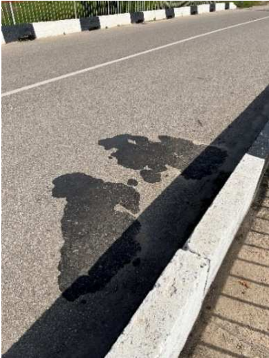
3 pav. Išplaukusi bituminė mastika.
