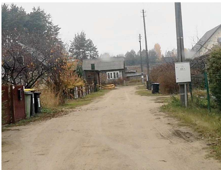
Pav. 6. Vilniaus g. kvartalinės gatvės Nr. 4 techninė būklė
