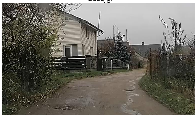
2 pav. Gatvių techninė būklė
