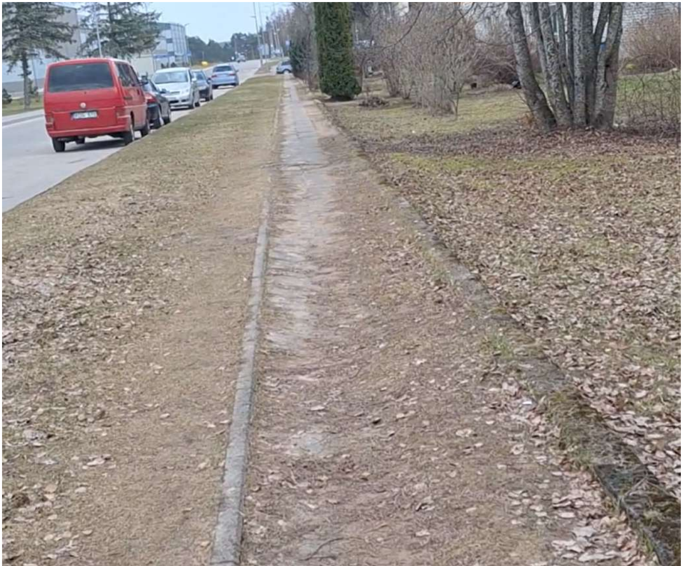
Pav. 10. Tako, esančio Arnionių g., techninė būklė
