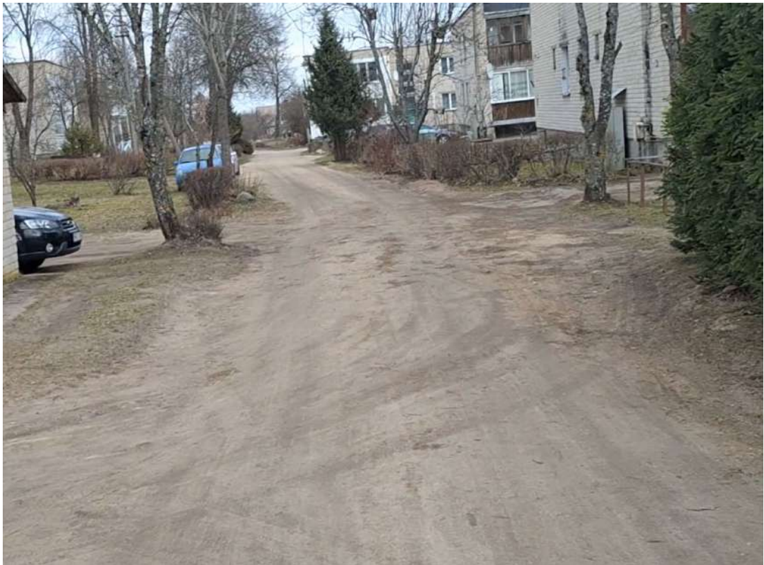
Pav. 8. Kvartālīnēs gatvēs Nr. 5 tehninē būklē
