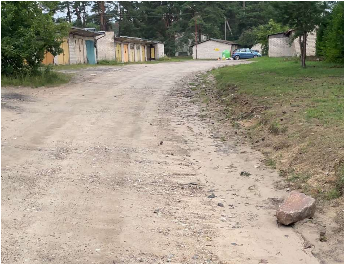
Pav. 6. Kvartalinės gatvės Nr. 3 techninė būklė
