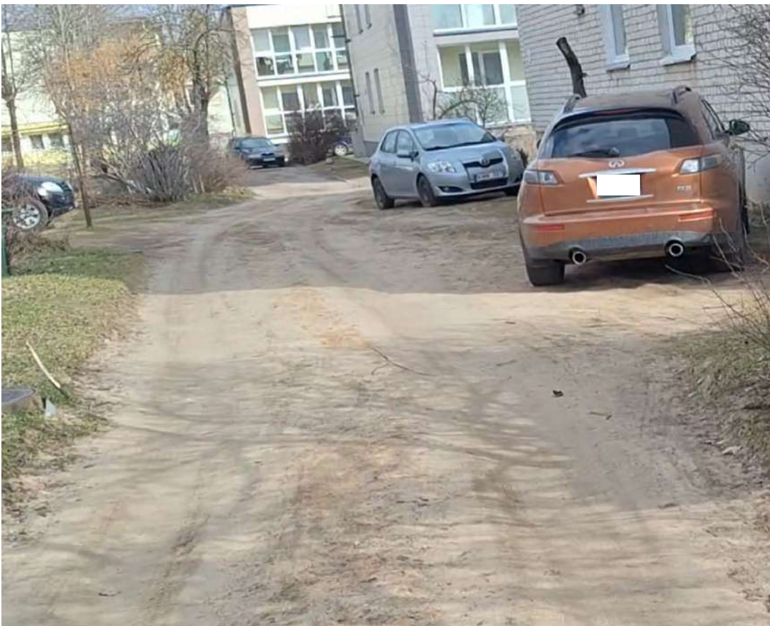
Pav. 9. Kvartālīnēs gatvēs Nr. 6 tehninē būklē
