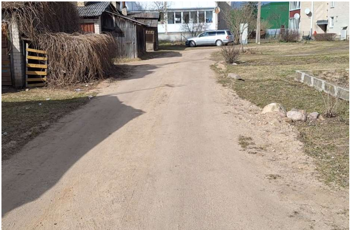
Pav. 7. Kvartalinės gatvės Nr. 4 techninė būklė
